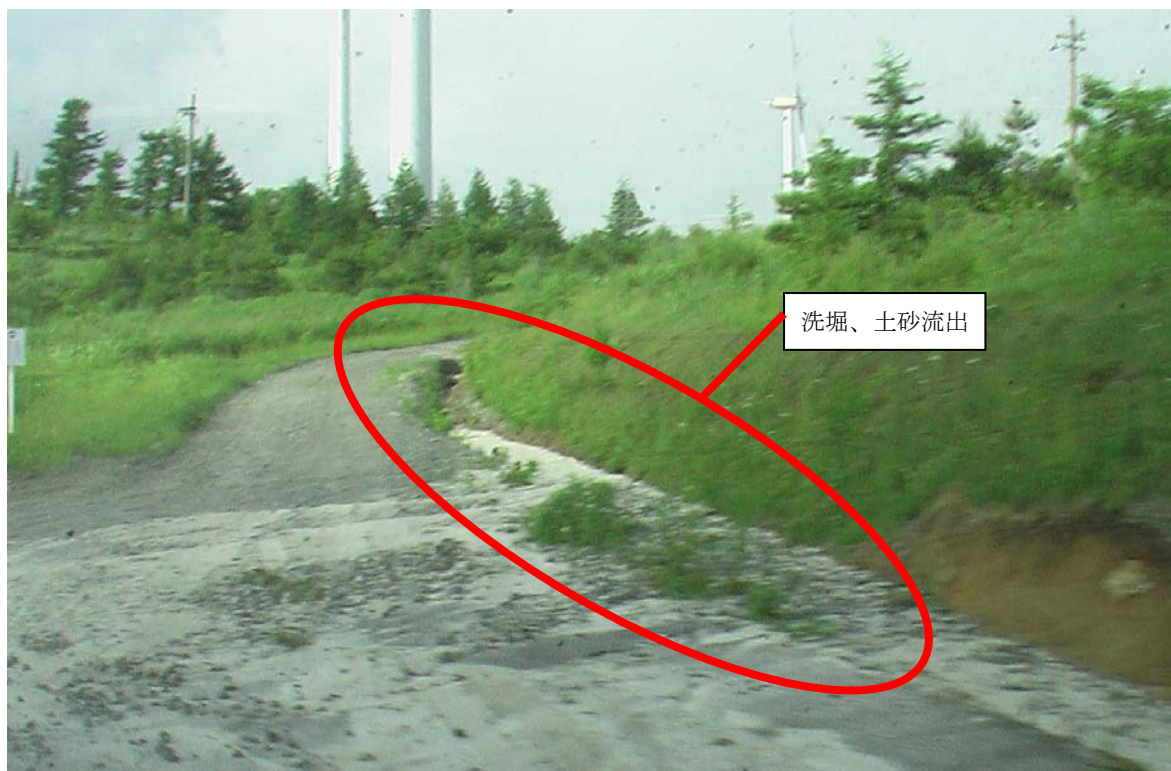
図5 道路脇が洗堀されて土砂が流出していた例 10
